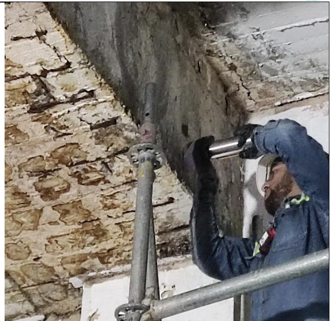
PRUEBA DE ESCLEROMETRIA AREA CON PERDIDA DE SECCION (NUCLEO 2)
