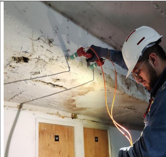
PRUEBA DE POTENCIAL DE CORROSION V-A.F
