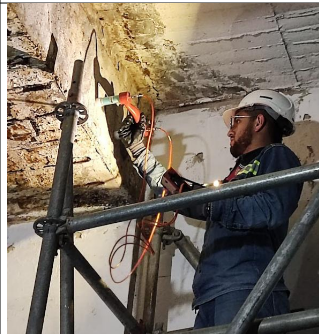
PRUEBA DE POTENCIAL DE CORROSION AREA CON PERDIDA DE SECCION
