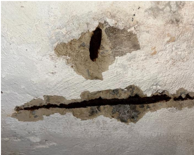
PRUEBA DE CARBONATACION V-A.F
