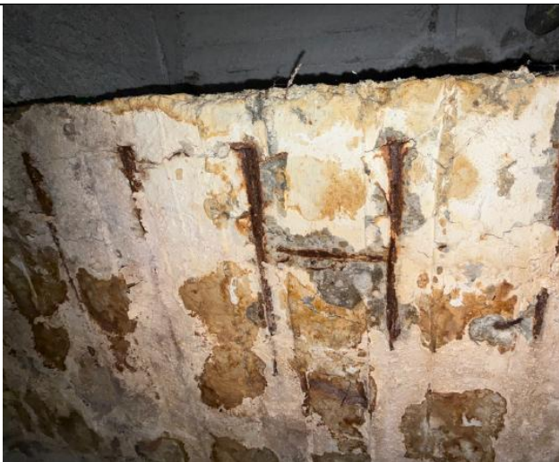
PRUEBA DE CARBONATACION AREA CON PERDIDA DE SECCION EN LOSA
